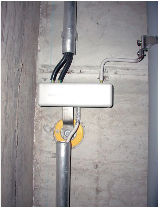
Bild 1: Haupterdungsschiene und Potentialausgleich
